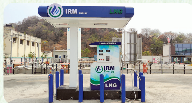
LNG Dispensing at Namakkal
