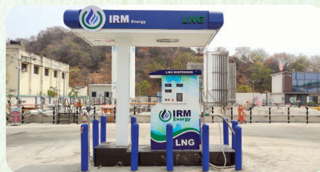
LNG Dispensing at Namakkal
